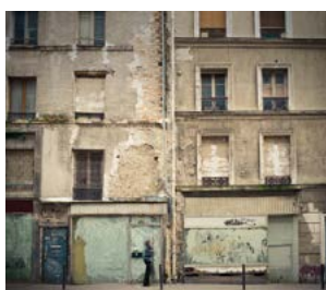
Immeuble insalubre et dégradé en secteur ORT et/ou OPAH. Promesse de vente signée le 1 er janvier 2022.
